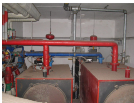
Particolare centrale termica a gas
