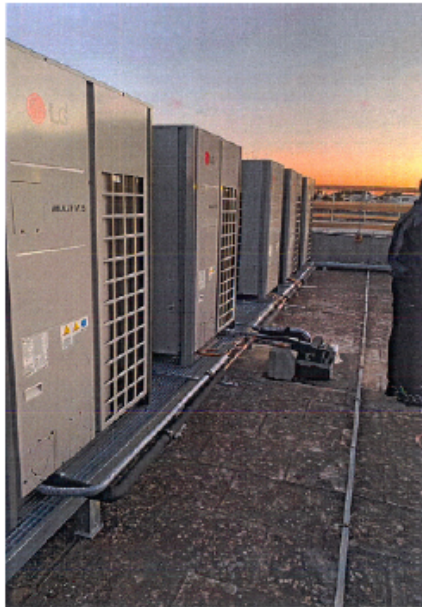
Particolare pompe di calore
