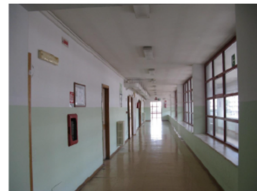
Particolare corpi illuminanti
